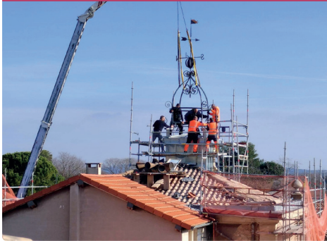
Étanchéification du toit de la mairie et réouverture de la salle du 1er étage
